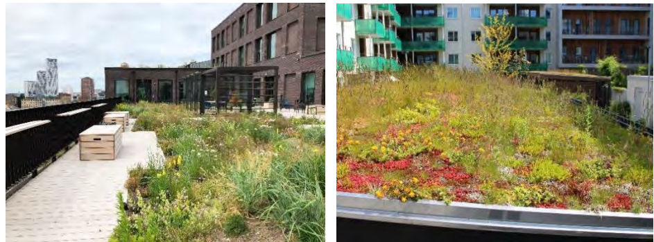
Figur 19. Referensbild för Gröna tak, ett tjockare biotoptak samt tunnare sedumtak.
